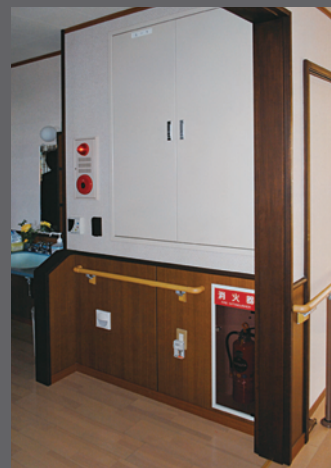
壁面に組み込まれた消火器と火災報知器
